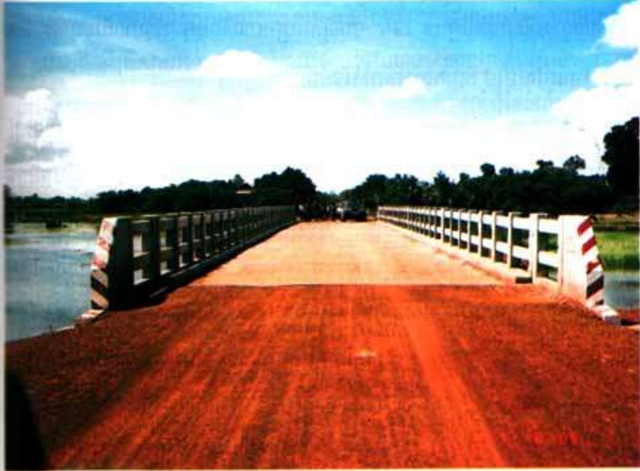
ស្ពាន និងផ្លូវកម្ពុជាតាមជម្រក ដែលកសាងដោយកងកម្លាំងវិស្វកម្មនៃកងយោធពលចមរុយ ទៅក្នុងការរួមចំណែក អនុវត្តគោលនយោបាយកាត់ទុយភាពក្រីក្រ របស់រាជរដ្ឋាភិបាល ។
